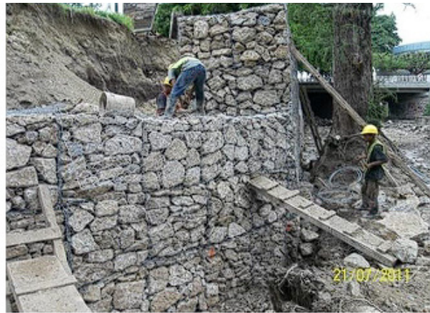
Figura 2.3. Muro de gavión (Cruz & Hernández, Noviembre 2012).
